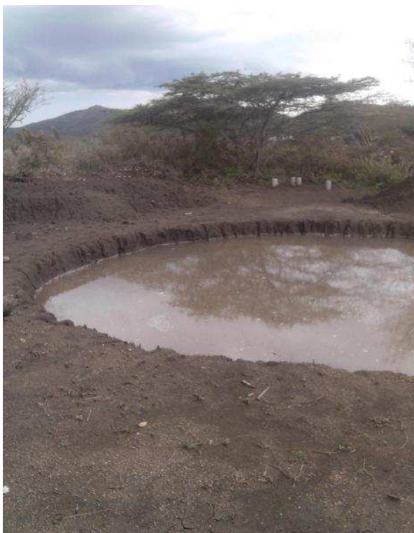
05 de septiembre: Lluvias torrenciales inundan el trabajo realizado.
